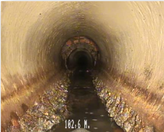
Dommages à la surface (S)
